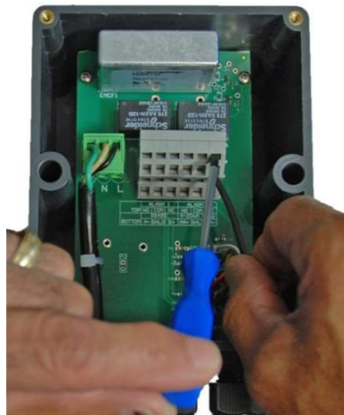
Figure 6 : Connexions électriques sur le bornier (P1)
